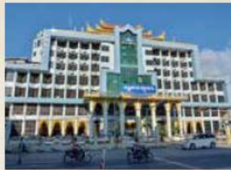
マンダレー駅舎。 ホテルも入居するビルだが老朽化が進む。
