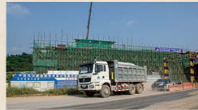
中老鉄路バンビエン駅近くの工事現場。土煙を上げてトラックが行き交う。
