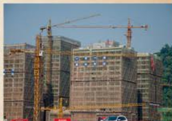
「磨丁特区」で建設中の商業ビル。「一帯一路」の文字が見える。
