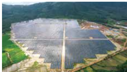
建設した太陽光発電所
