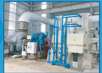
タービン発電機
