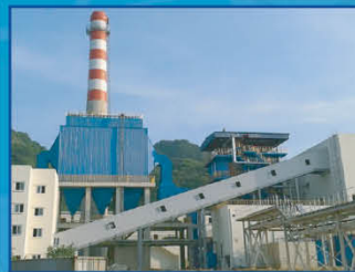
ボイラーシステム
