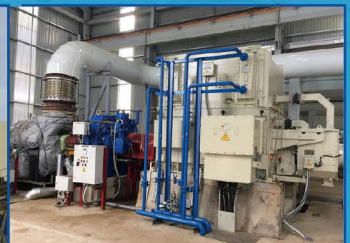
タービン発電機
