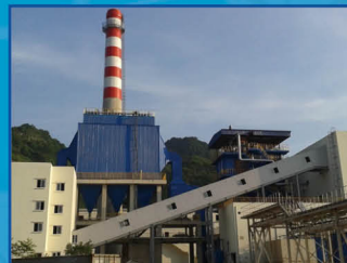
ボイラーシステム
