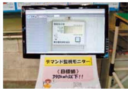
現在、節電対策のために監視モニターを設置し、リアルタイムで数値を把握している。
