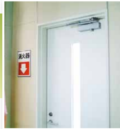
地震で工場内に閉じ込められた際に逃げられるように、今回の震災後にドアが取り付けられた。元は一面ただの壁。
