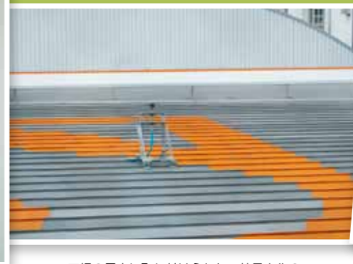
工場の屋上に取り付けられた、社員自作の sprinkler
